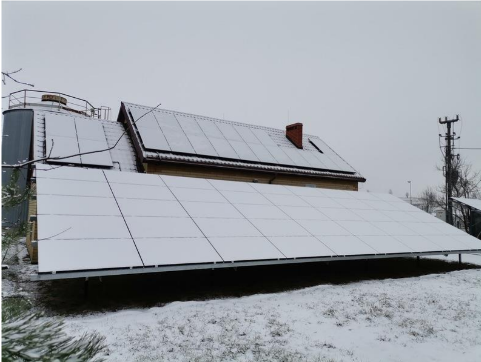
Rysunek 3.1.2. Instalacja na terenie Stacji Uzdatniania Wody w Jeleniewie
